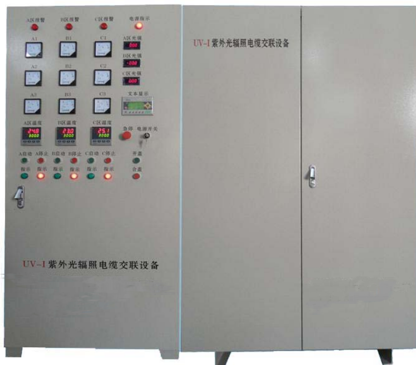
图 2-3 控制柜及灯源供电柜组图
